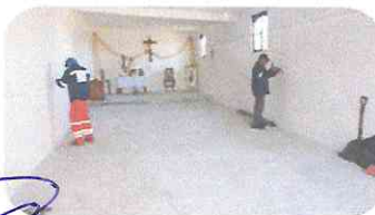
Imagen 3. Instalación eléctrica en Capilla de El Cedazo Fuente: elaboración propia (2025)
